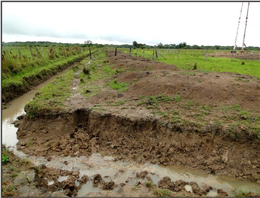
Foto N°2. Zanja aledaña al área que desemboca en un caño cercano.
