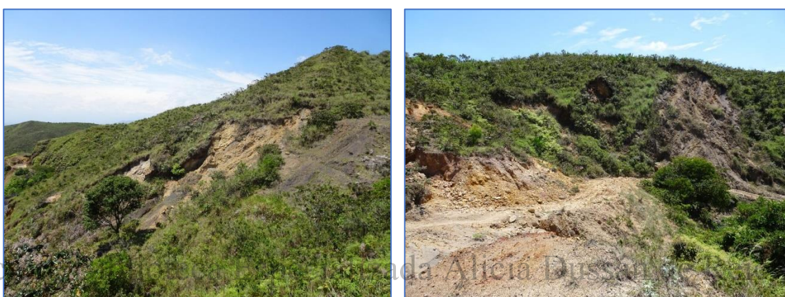
Fotos N°37 y 38. Zonas con erosión por desprendimiento e intervenidas en años anteriores.
