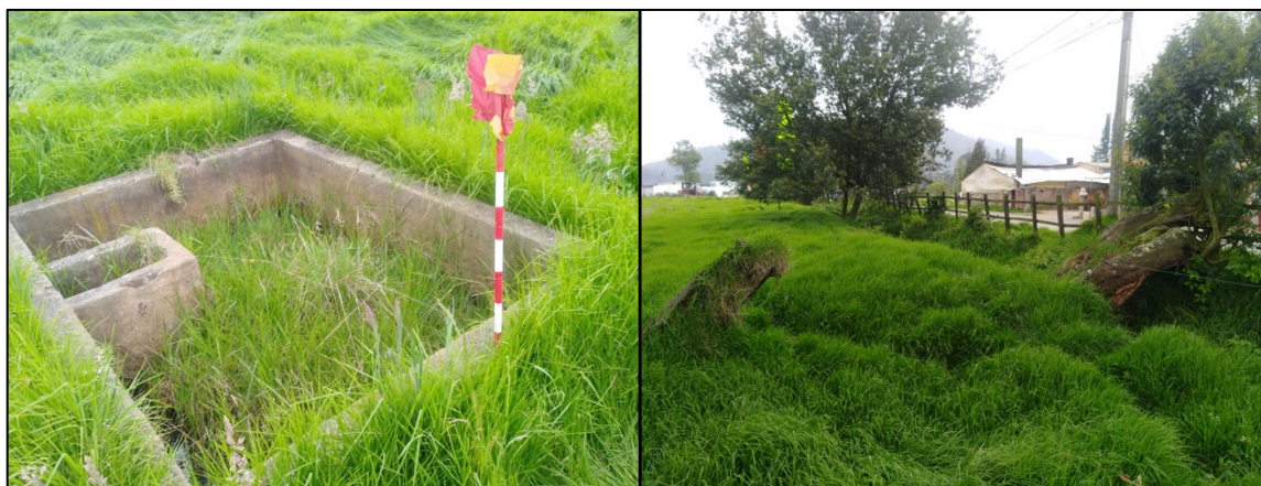
Fotografía 2. Alteraciones menores evidenciadas durante el trabajo de campo (canal de desagüe a la derecha y bebedero para ganado a la izquierda), proyecto Sauko Zipaquirá.
