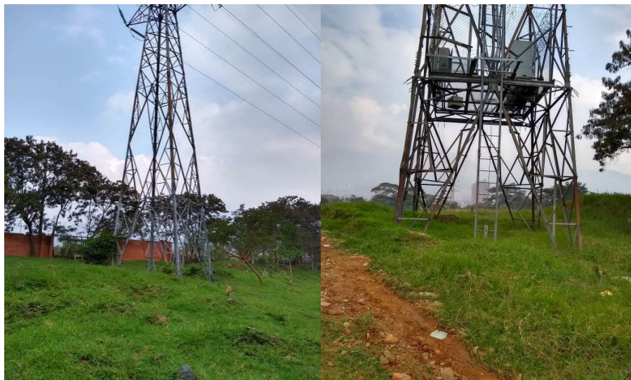
Fotos 66 y 67. Torres para la línea de energía de alta tensión que atraviesa el Lote Tulio Ospina en dirección norte-sur.
