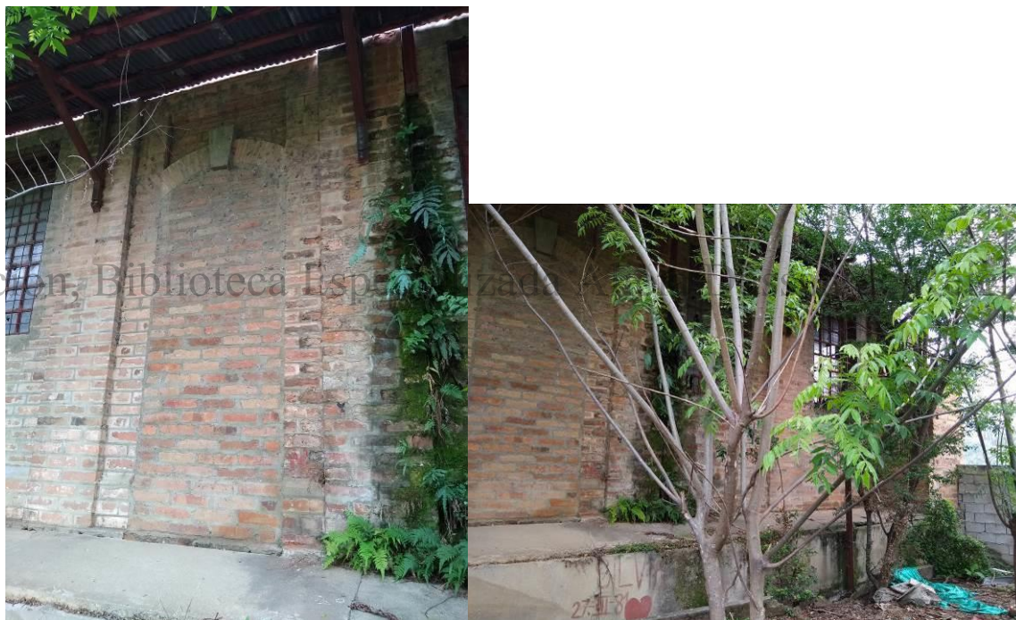
Fotos 59 y 60. Algunas estructuras han sido invadidas por malezas, como la parte trasera de los Talleres del Antiguo Ferrocarril de Antioquia.
