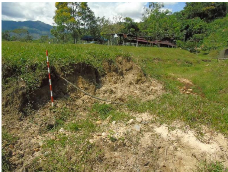
Fotografía 13. Inspección de espacios erosionados al interior del ZODME 26.
